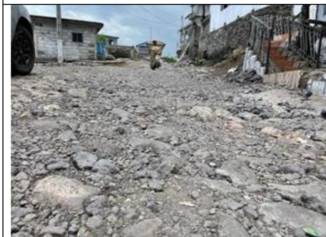
Photo 15: Route complètement dénudée de matériaux de chaussée, pente forte, absence de drainage longitudinal
