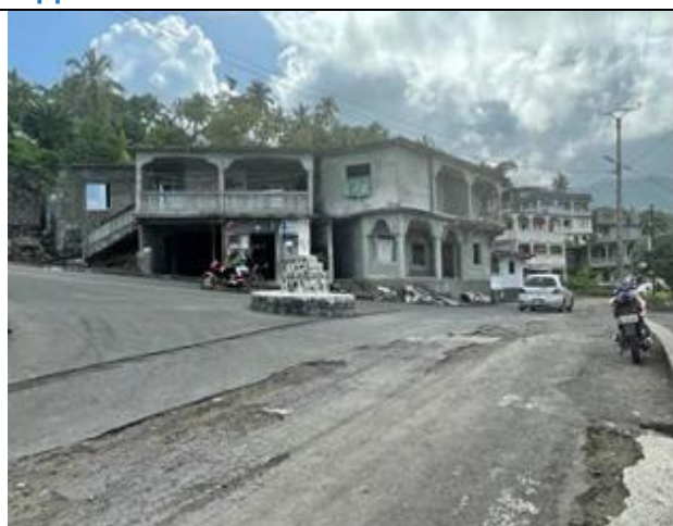
Photo 16: Chaussée existante détériorée. Ligne électrique longeant l'emprise
