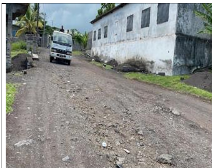
Photo 13: pente forte au niveau des traversées des villages, route en état de piste dépourvue de matériaux de chaussée
