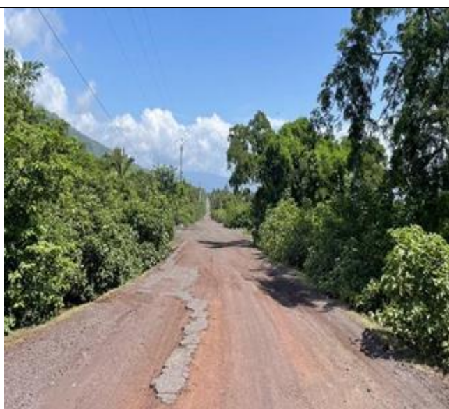
Photo 8 : Chaussée existante détériorée. Ligne électrique longeant l'emprise
