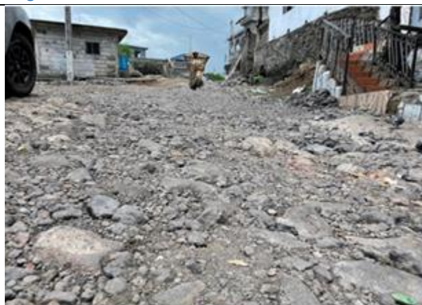
Photo 5: Chaussée érodée au niveau des traversées des villages. Pentes longitudinales fortes.
