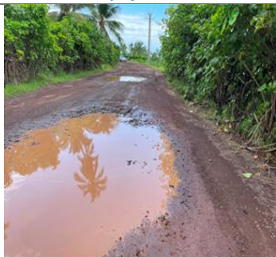
Photo 4: Stagnation d'eau au niveau de point bas non équipé
