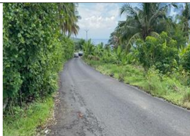
Photo 12 : Revêtement existant en bon état. Abords de la chaussée envahis par la végétation
