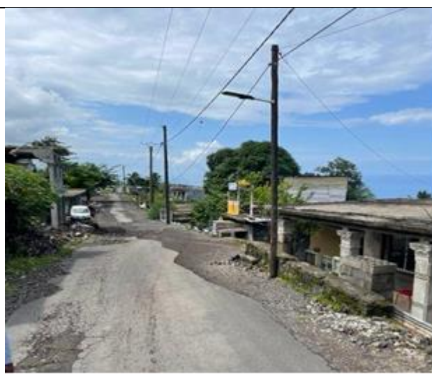
Photo 14: revêtement détériorée, absence de dispositif de drainage, route en hauteur par rapport aux constructions de rive
