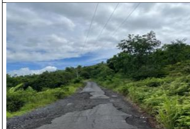
Photo 11: Couche de revêtement fortement dégradée
