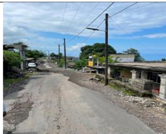
Photo 6 : Chaussée existante détériorée. Ligne électrique longeant l'emprise au niveau de la traversée d'agglomération
