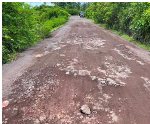
Photo 3: Ravinement de la plateforme. Revêtement dégradée. Emprise envahie par la végétation
