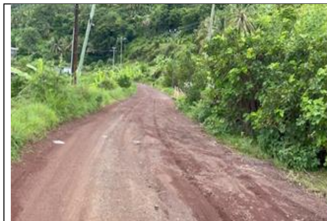
Photo 9: Ravinement de la plateforme. Revêtement dégradé. Emprise envahie par la végétation
