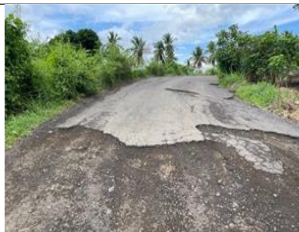
Photo 10 : Couche de revêtement dégradée
